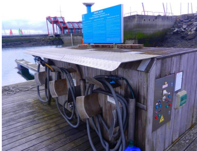
Figure 56 : Photographie de la station bleue
