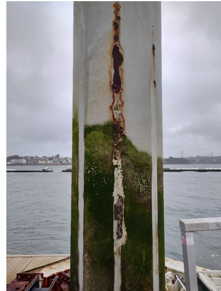
Figure 9 : Photographie corrosion pieux de guidage
