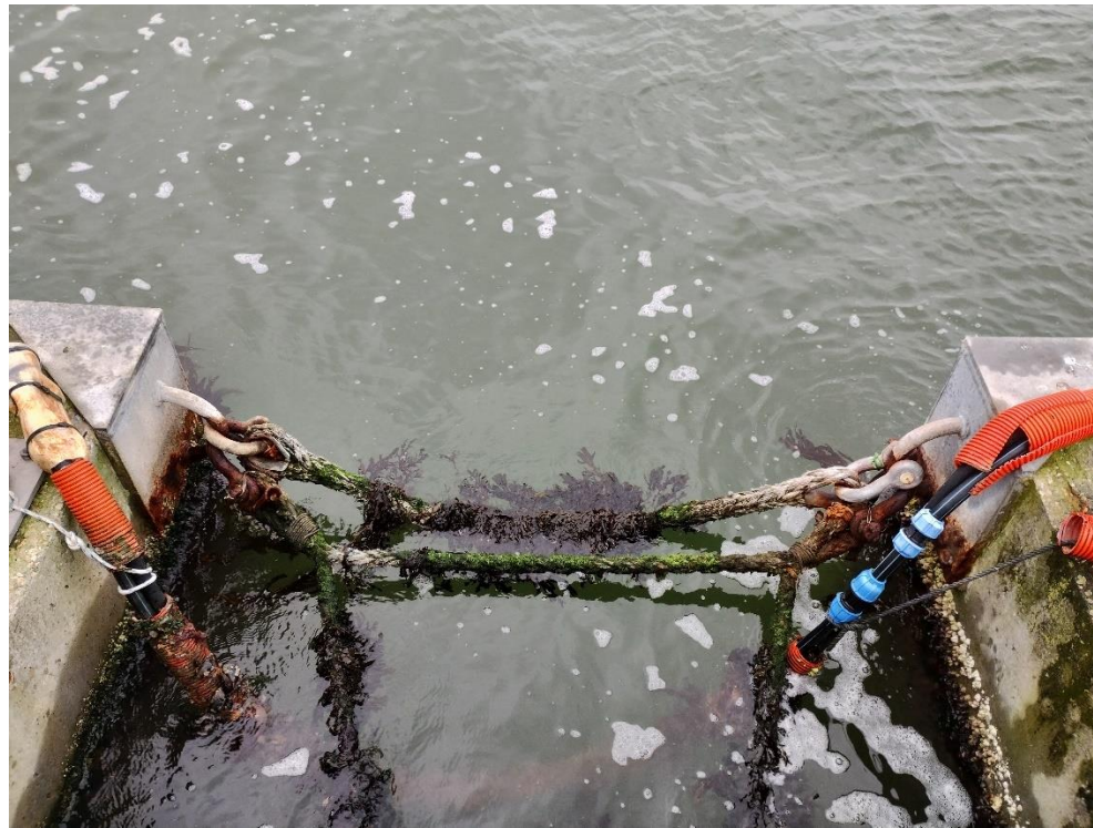
Figure 10 : Défaut platines pour amarres et amarres dégradées
