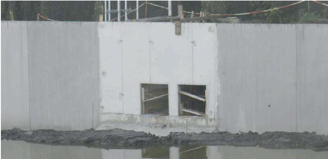
Figure 37 : Vannes I1 et I2 de la digue de Moulin Neuf
