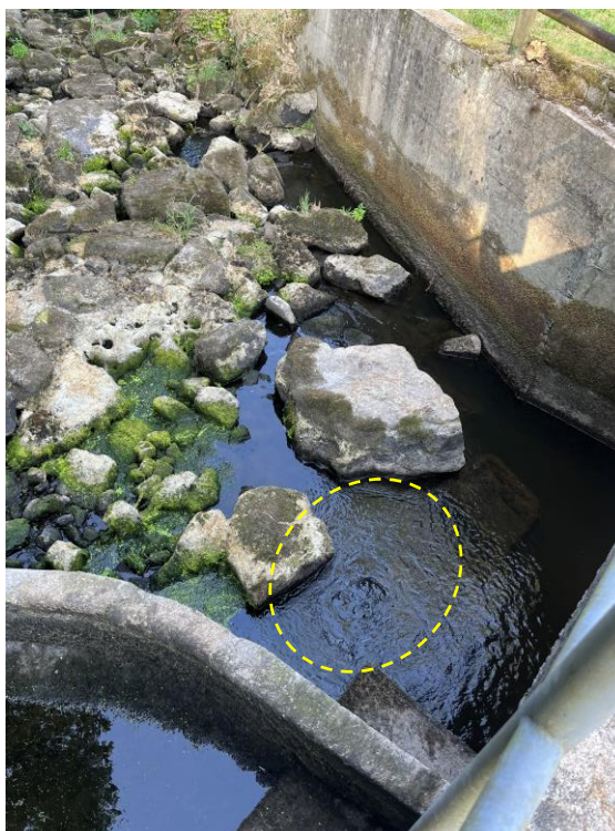
Résurgence constatée à l'aval de la digue liée à la présence d'un renard sous le radier de vannage. Sous-cavement nécessitant un traitement rapide, au risque d'aggravation de la situation et de la détérioration de l'ensemble de l'ouvrage
