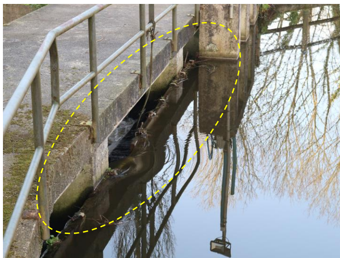
Système de réhausse du niveau d'eau à sécuriser et remplacer
