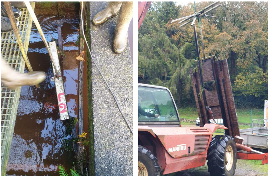
Casse de la vanne d'alimentation du sas du dégrilleur ( et de bache de pompage vers l'usine de production d'eau potable) ayant nécessité sa dépose. La vanne devra être remplacée par un équipement neuf
